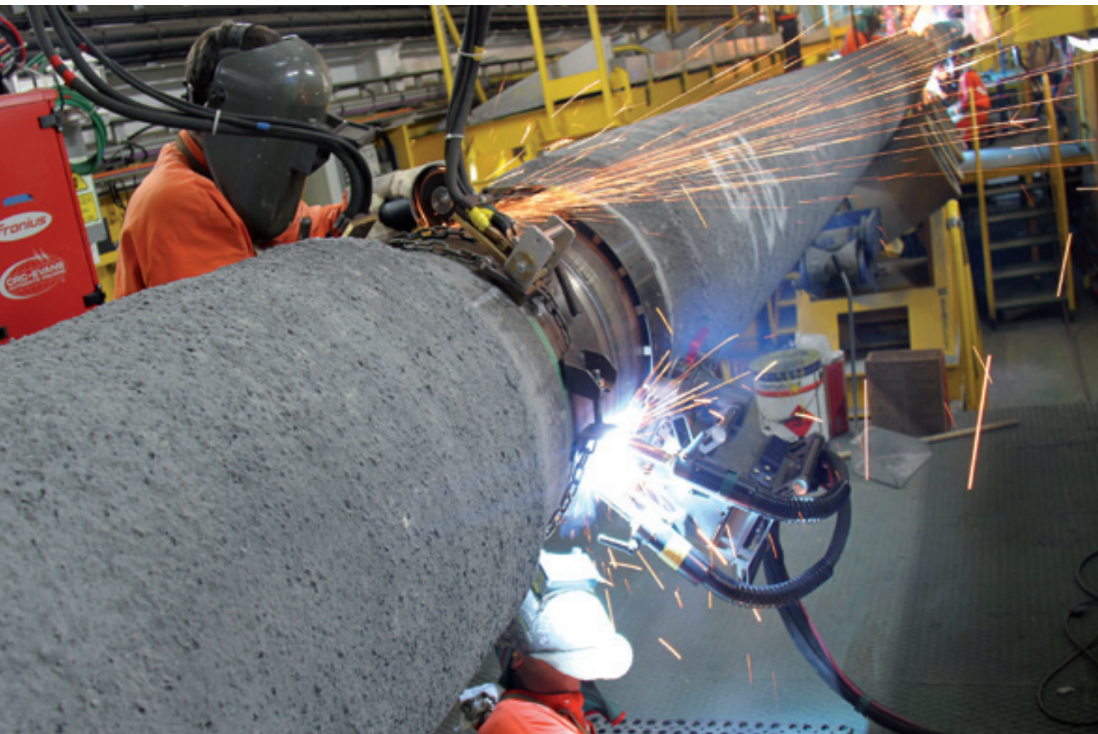
Das italienische Unternehmen Micoperi verschweißte die Rohre auf einem Verlegeschiff und installierte die Pipeline in 50 bis 80 Metern Tiefe auf dem Meeresboden vor der Küste Israels
